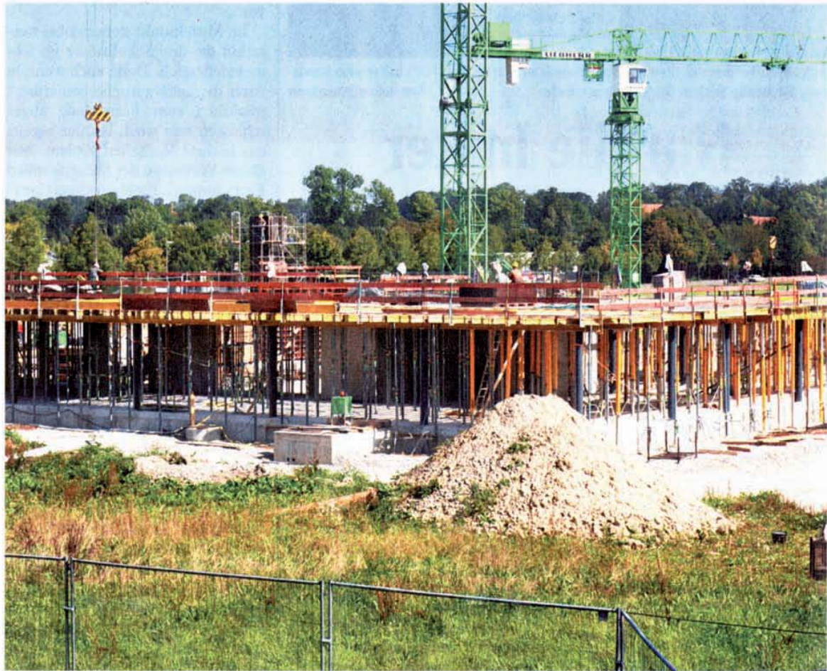
Die neue Realschule in Kaufering wächst und wächst. Bei der Vergabe von Aufträgen muss der Landkreis Richtlinien beachten, die immer wieder in der Kritik stehen, weil heimische Unternehmen nicht zum Zuge kommen.
